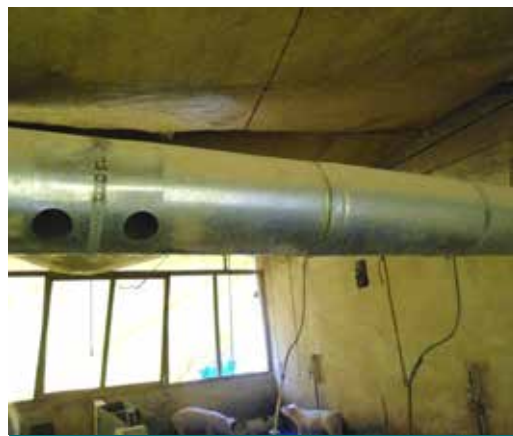
Figura 27. Sistema de aquecimento de ambiente de creche: caldeira a biogás e ar quente.
